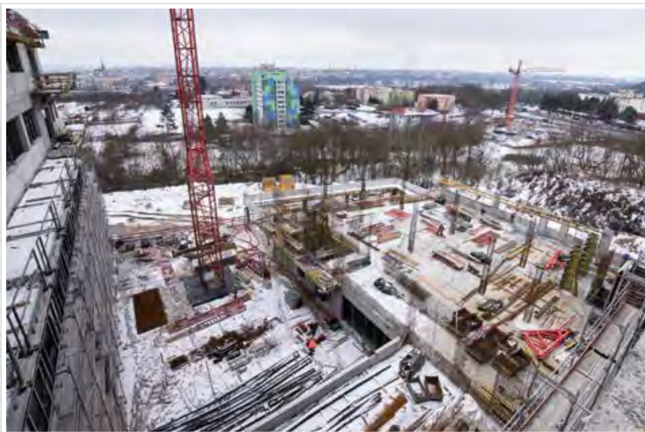
Leden 2021 – pohled na křídlo děkanátu a menzy – dokončen skelet prvního podlaží z celkových čtyř.
